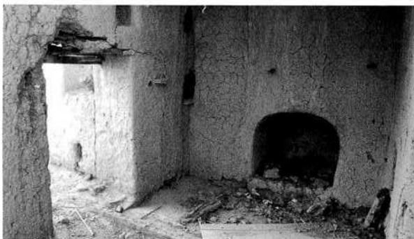
الشكل ٥ - ١٦: حارة فتجاء، شقوق الكساء
