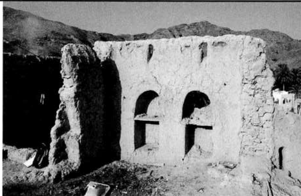
الشكل ٥ - ١٥: حارة فتجاء، تصدّع الجدران
